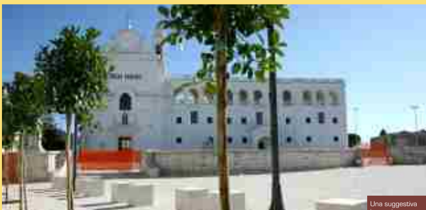
Una suggestiva immagine della basilica. L'inaugurazione del nuovo sagrato è prevista per sabato 25 novembre. I lavori sono costati circa trecentomila euro e sono stati realizzati da un'impresa di San Severo
