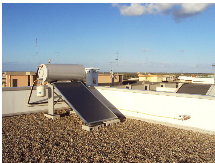
Pannello solare termico e boiler in copertura
