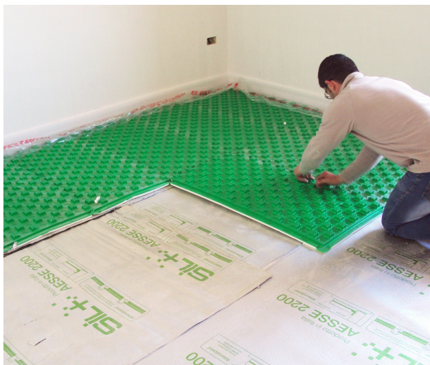
Barriera acustica e pannello isolante per pavimento radiante
