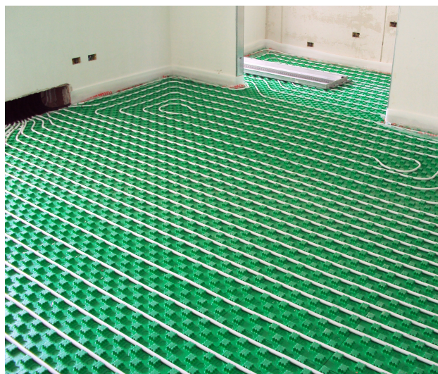
Impianto radiante con tubi in multistrato
