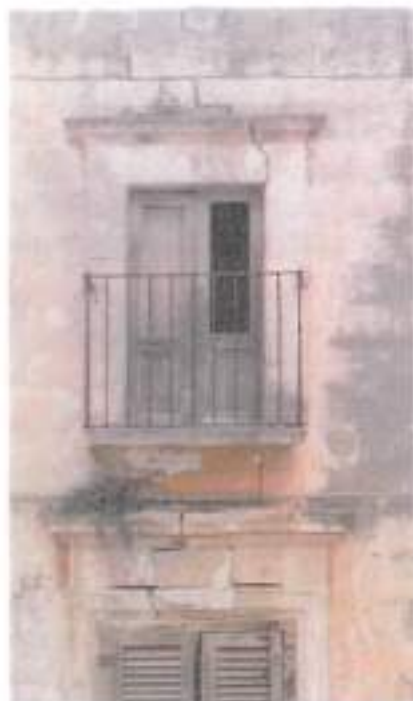
Macrolesioni e cedimenti architravi sulla facciata di via Regina Sforza
