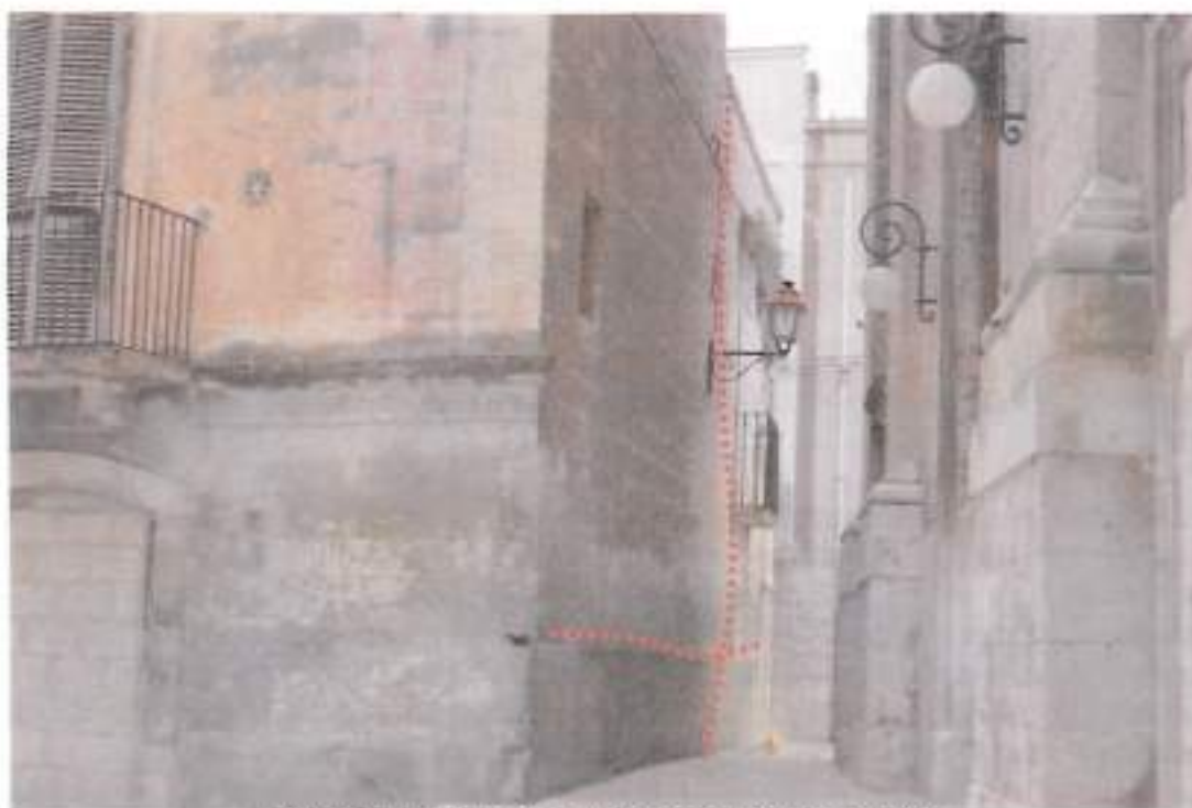
Vista dello "spanciamento" in atto della facciata laterale dell'edificio
