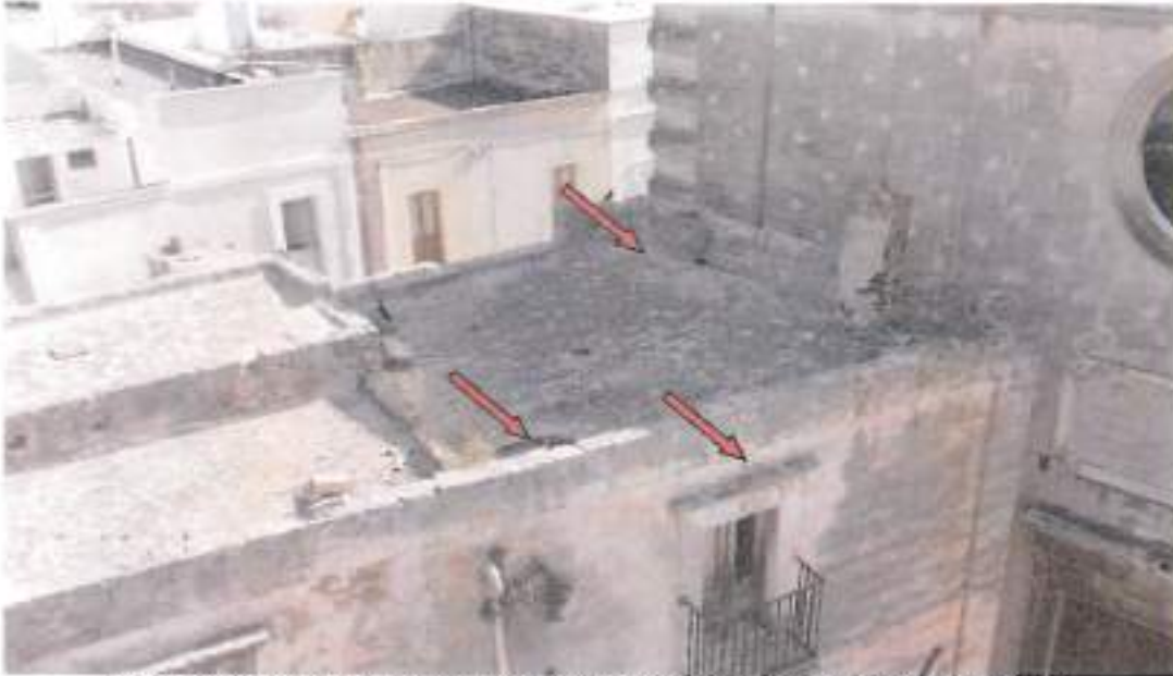
Vista dall'alto: noti il foro in copertura e le lesioni perimetrali che attestano il cedimento del tavolato e il cinematismo di roto – traslazione delle facciate
