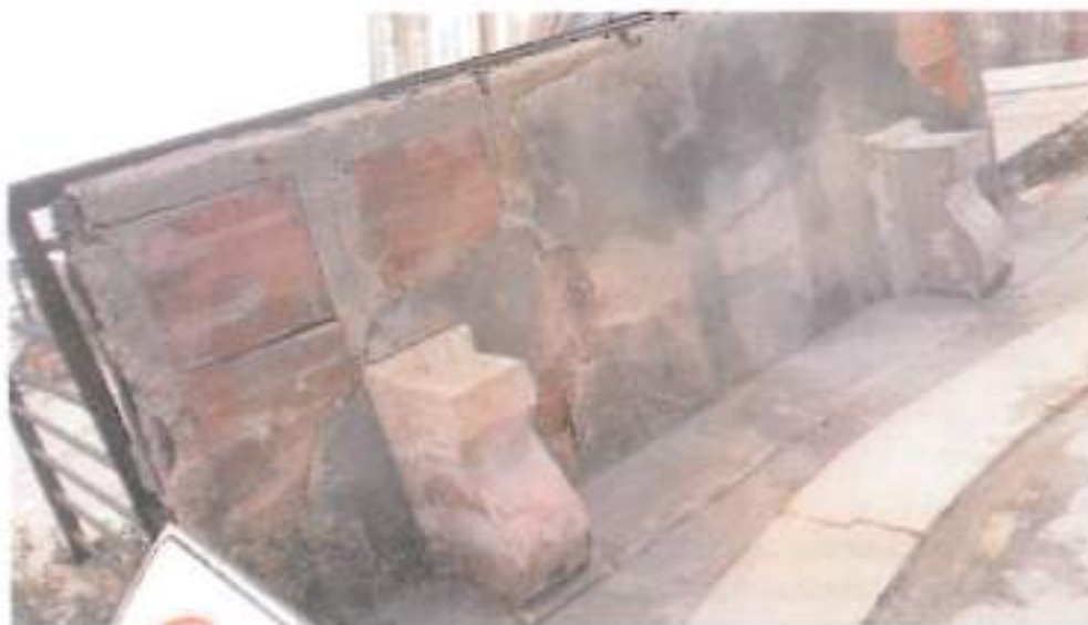
Vista del balcone con distacco di parti in cls e ossidazione dei ferri di armatura
