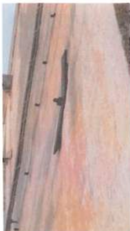
Catena a piano primo in evidente stato tensionale
