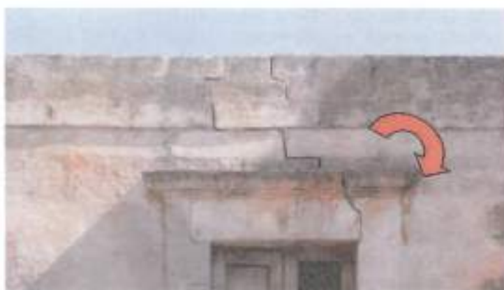
vista della lesione dell'architrave della finestra a 2° piano ove è visibile il cinematismo di rotazione
