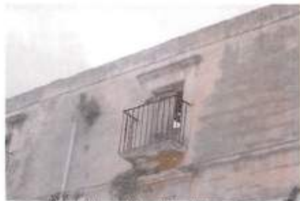
Vista dal basso del parziale crollo in copertura
