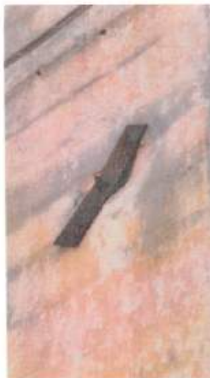
Catena a piano primo in evidente stato tensionale con danneggiamento della muratura perimetrale
