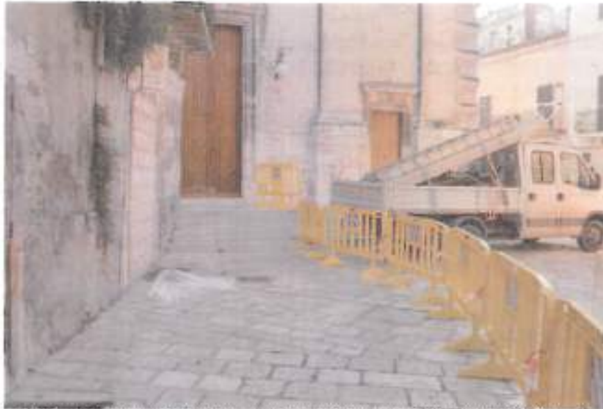
Transennamento area di margine a seguito dell'Ordinanza n.118/2016 della Polizia Locale
