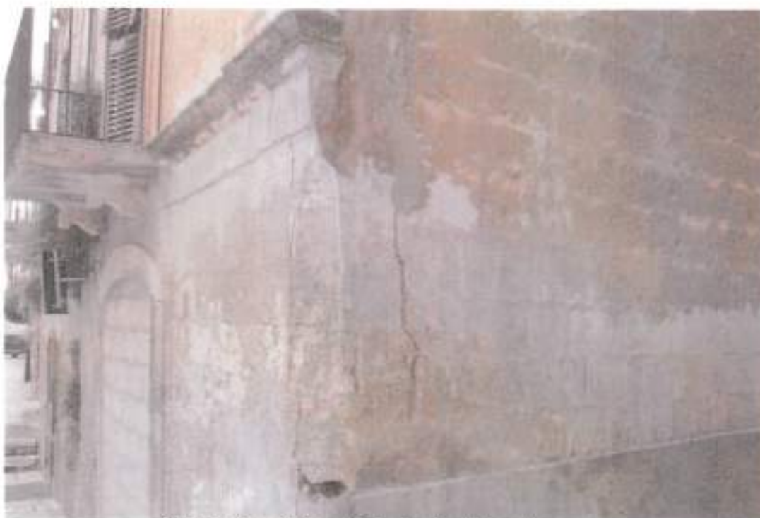
Particolare del quadro fessurativo in elevazione della muratura angolare
