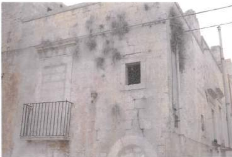
Vista del quadro fessurativo e della vegetazione sulle facciate di via Carone
