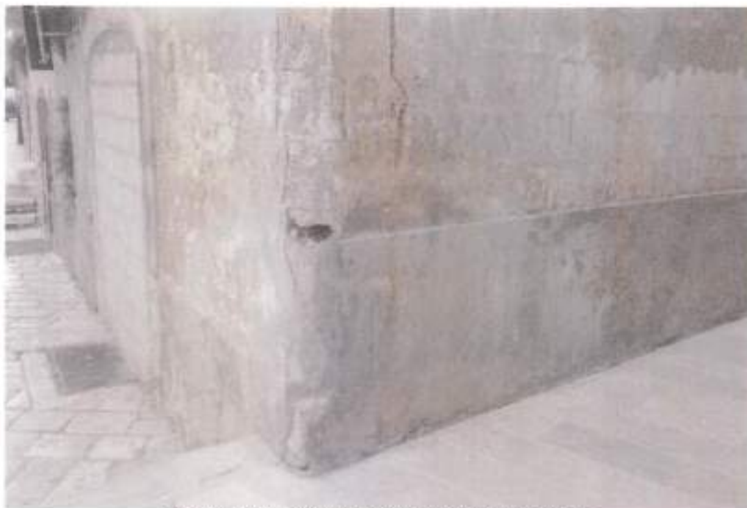
Particolare del quadro fessurativo alla base della muratura angolare
